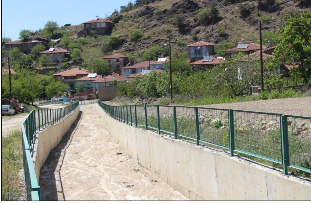
Fotoğraf 152: Tozman Deresindeki Taşkın Kontrol Duvarları
