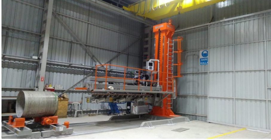
Şekil 3.20. Kaynak makinesinin bağlı bulunduğu kolon bom sistemi.
