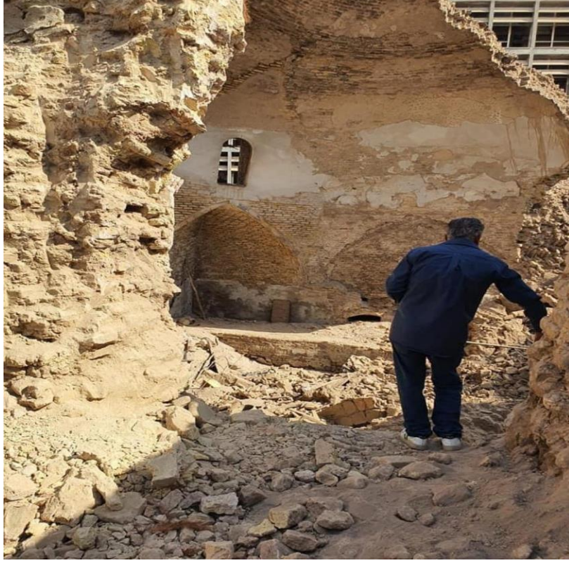
Fotograf 68: Paşa hamamı'nın durumu
