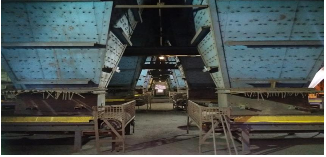
Şekil 3.3. Dozajlama tesisi bunkerleri [13].
