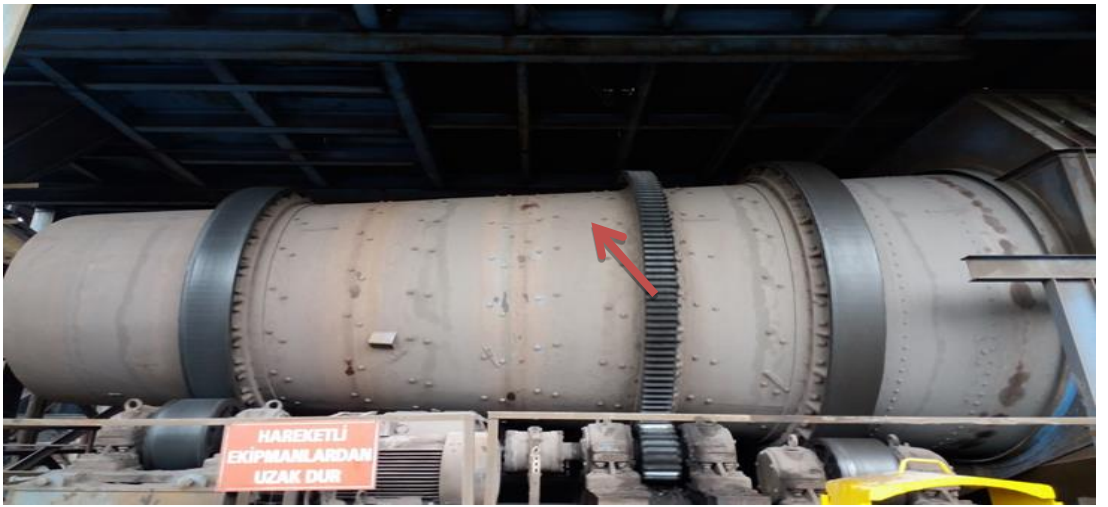
Şekil 3.4. Karıştırma işleminin yapıldığı ekipman (tromel)
