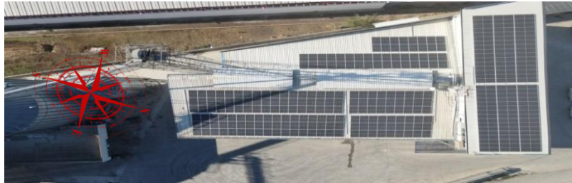
Şekil 3.1 Gölgeleme oluşan tesise örnek.
