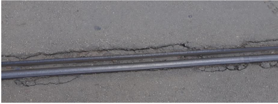
Şekil 7 Gizli boşluk oluşan hattaki bozulma.
