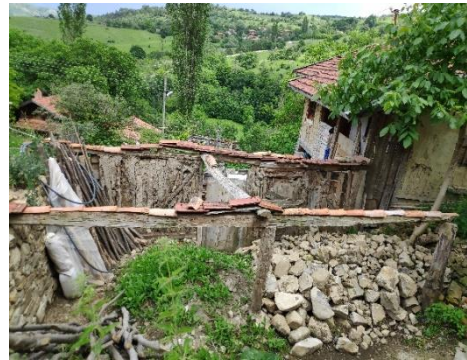
d) Harabe durumda yapı örneği (Çataklı mahallesi)
