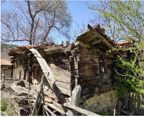
d) Yıkık yapı örneği (Yuvalar mahallesi)
