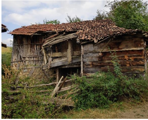
e) Yıkık çatı örneği (Dudan mahallesi)
