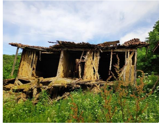
d) Yıkık yapı örneği (Dudan mahallesi)
