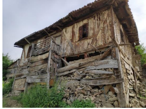
c) Kötü durumda yapı örneği (Dudan mahallesi)
