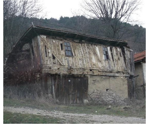
e) Yıkık çatı örneği (Çatakli mahallesi)
