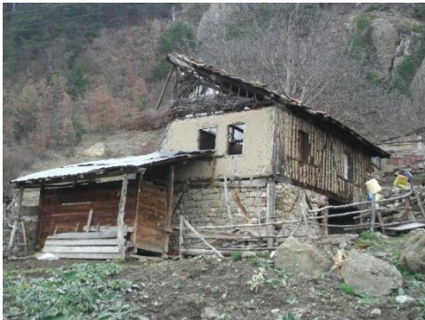
d) Harabe durumda yapı örneği (Aşağı Kayalar mahallesi)
