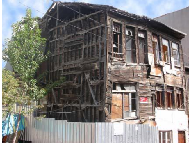
Şekil 3. Bilinçsiz ahşap taşıyıcı sistem kurgusunun yapı hasarına etkisi [3]
