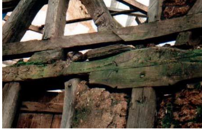
Şekil 9. Mantar ve bakterilerin ahşap yapıya etkisi [7]
