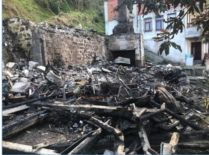
Şekil 4. Sürmene İlçesi, Soğuksu Mahallesi'nde çıkan yangın sonucu kullanılmaz hale gelen konut.
