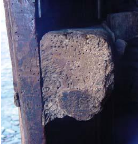
Şekil 10. Kurt ve böceklerin ahşap yapıdaki etkisi [7]
