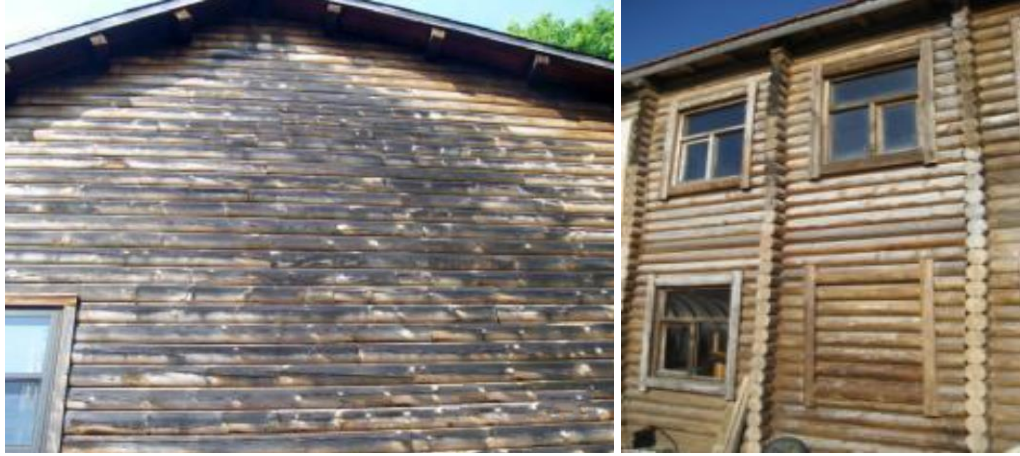
a) cephede kararma b) güneş alan kısımda renk değişimi Şekil 5. Atmosfer etkileri nedeniyle ahşap yapı cephesinde oluşan değişimler [5, 6]
