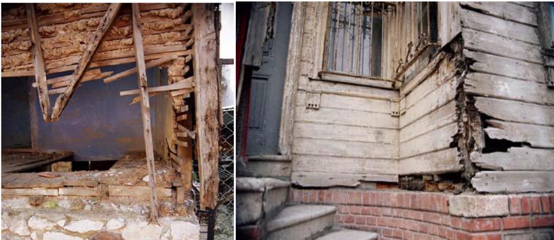
Şekil 12. Duvar-ahşap bağlantılardan kaynaklanan ahşap yapı hasarlarından görünüm [3]
