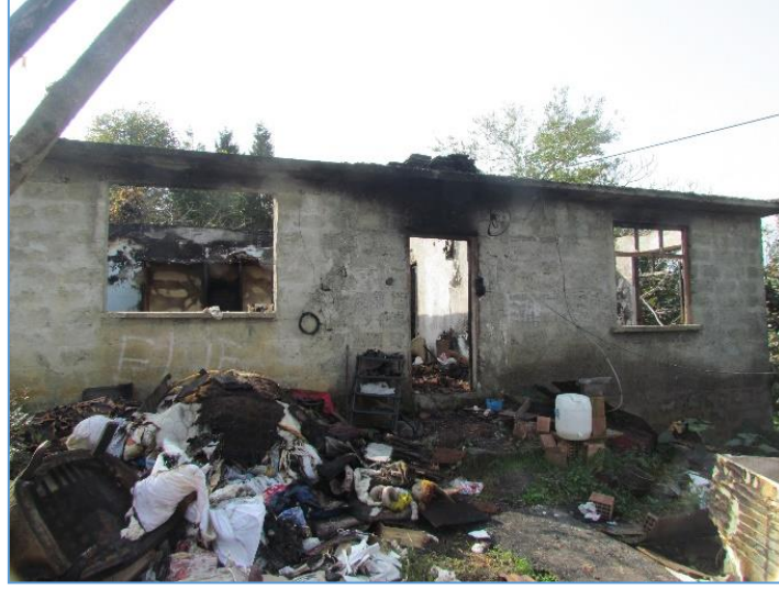
Şekil 3. Yomra İlçesi, Sancak Mahallesi'nde çıkan yangın sonucu kullanılmaz hale gelen konut.
