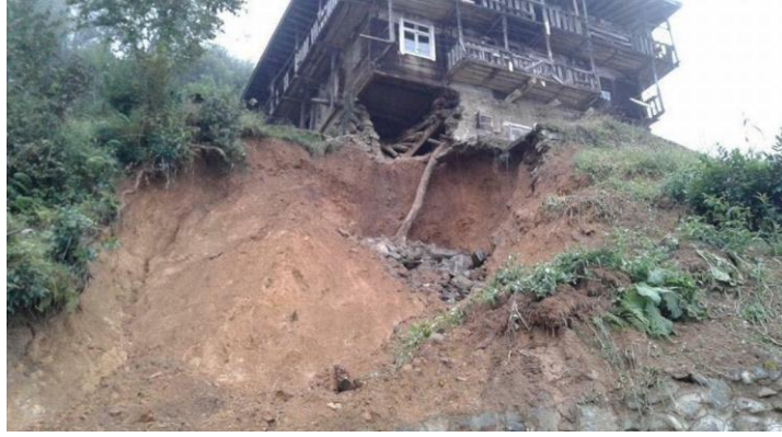
Şekil 1. Rize'de sel ve heyelan nedeniyle ahşap yapı temelinde oluşan hasar [1]
