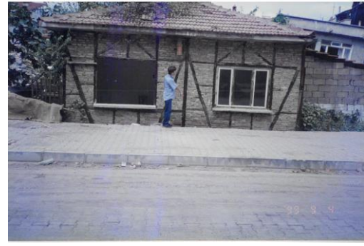
(b) Sıvılaşma ve aşırı mukavemet kaybı olan zeminde geleneksel eski bir yapıda oluşan oturma
