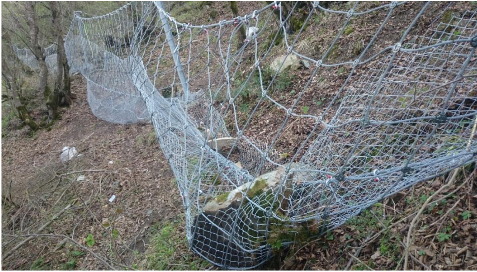
Şekil 4. Maçka Güney Mahallesi'nde esnek bariyerler.
