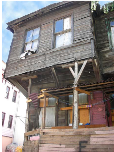
Şekil 14. İşçiliğin kötü olmasının yapı üzerindeki etkisi [3]
