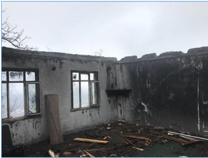
Şekil 2. Düzköy İlçesi Çalköy Mahallesi’nde çıkan yangın sonucu kullanılmaz hale gelen konut.
