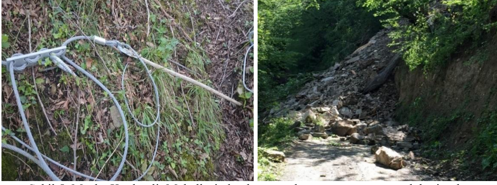
Şekil 5. Maçka Kanlıpelit Mahallesinde oluşan toplu göçme sonrası esnek bariyerler.
