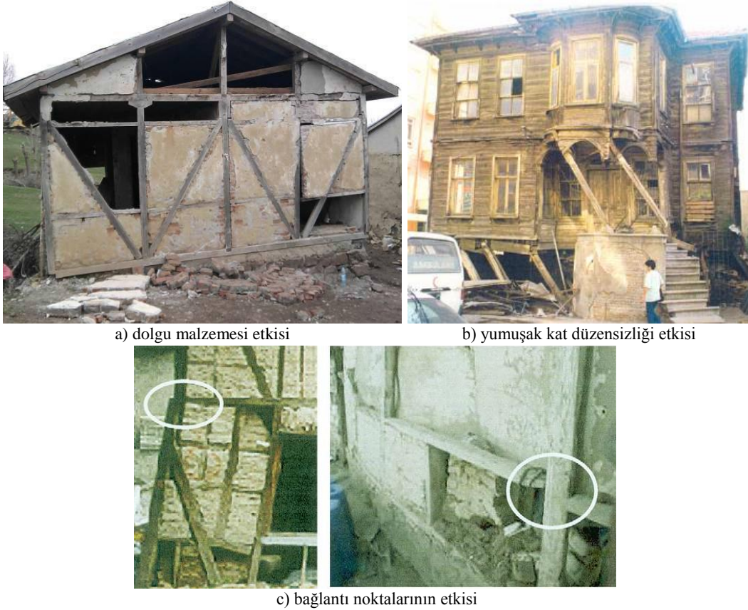
Şekil 7. Farklı etkiler nedeniyle depremler sırasında oluşan ahşap yapı hasarlarından görünüm [8, 9]
