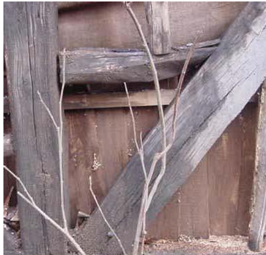
Şekil 6. Su ve nem olayının ahşap yapıya etkisinden bir görünüm [7]
