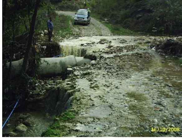
Şekil 1. Sinop Ayancık İlçesinde tıkanmış bir beton büzler ve yol üzerinden akan su.
