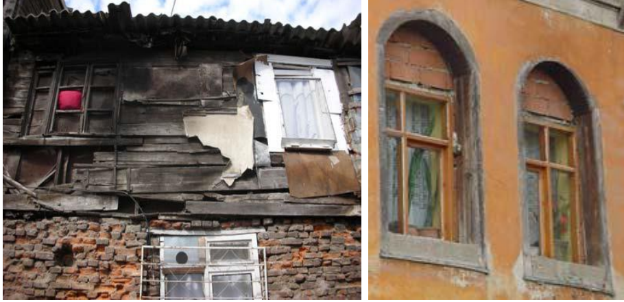
Şekil 13. Ahşap yapı onarımındaki hatalı uygulamalardan görüntüler [3]
