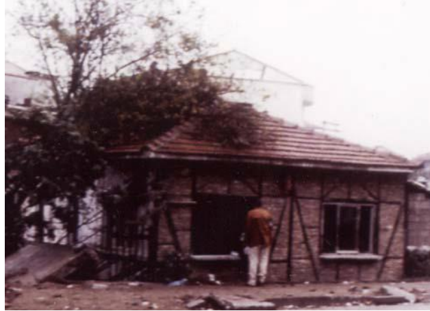
Şekil 2. Adapazarı'nda sıvılaşma sonucu oluşan zemin oturmasının ahşap yapıya etkisi [2]
