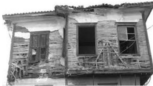
Şekil 4. Bilinçsiz ahşap taşıyıcı sistem kurgusunun yapı hasarına etkisi
