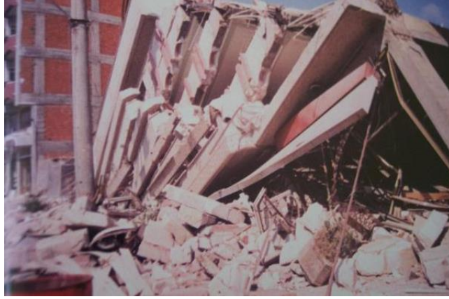
Şekil 3. Güçlü kiriş-zayıf kolon hatası sonucu yıkılan bir bina (1999 Marmara depremi, Adapazarı)
