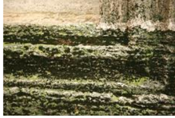
Şekil 2.13. Taş cephede görülen mikroorganizma oluşumları (Ersen, 2013).
