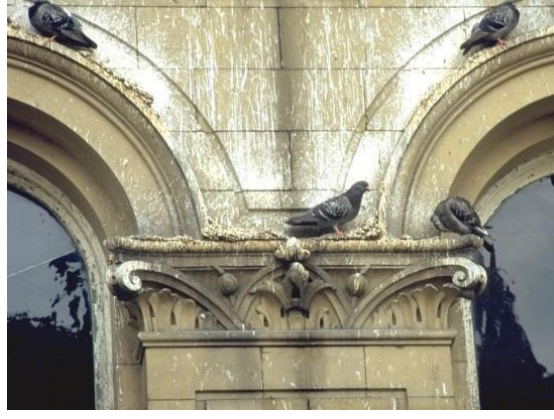
Şekil 2.21. Kuş atıklarının yapı cephesinde neden olduğu kirlilik (İnternet, 5).
