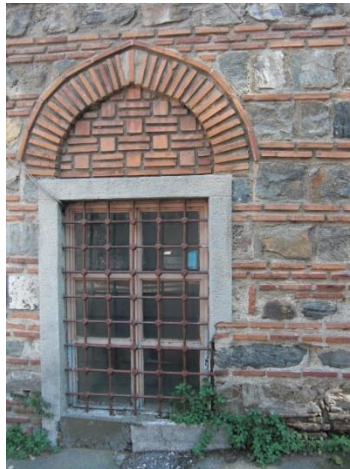
Şekil 5.38. Demir parmaklıkların ankraj noktalarında meydana gelen paslanmaya bağlı bozulma.
