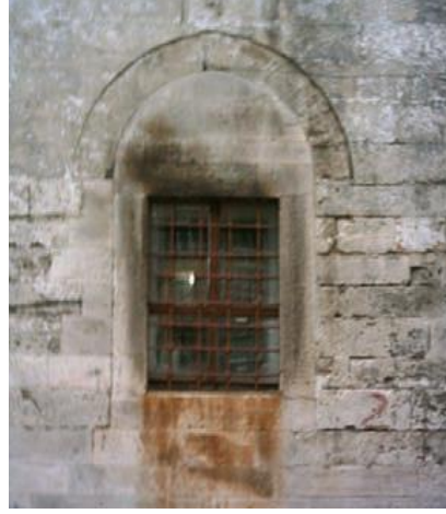
Şekil 2.19. Taş yüzeyde akıntı sonucu meydana gelen pas lekesi (Dal, 2010).
