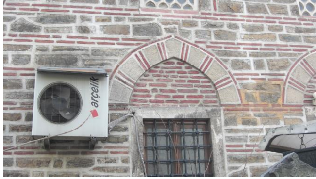
Şekil 5.20. İmaret-i İsabey Camii cephesindeki pas lekeleri.
