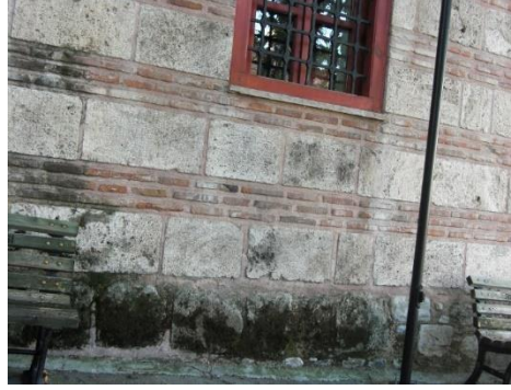
Şekil 5.28. Duvar eteğinde meydana gelen yosunlaşma.
