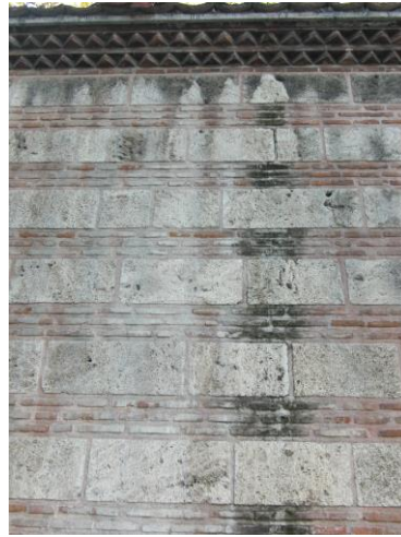
Şekil 5.29. Oluk hasarından dolayı çatıdan duvar yüzeyine akan suyun neden olduğu yosun oluşumu.
