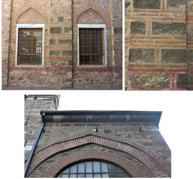
Şekil 5.14. Üftade Camii cephesindeki kararmalar.
