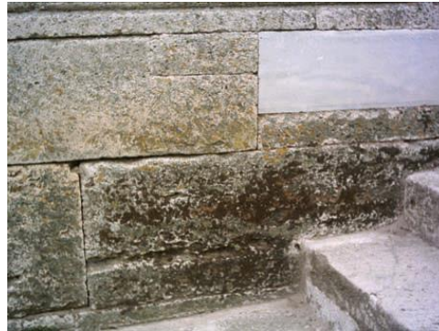
Şekil 2.22. Taş cephede yosunlaşma oluşumu, (Dal, 2010).
