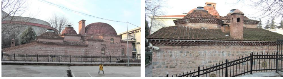
Şekil 5.33. Yapı üzerindeki tuzlanmalar ve akıntı nedeniyle oluşan kirlilikler.
