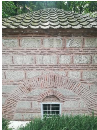
Şekil 5.27. Saçak ve saçak alt kısmında görülen tuzlanma.
