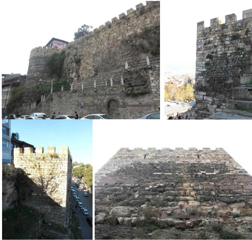
Şekil 5.3. Osmangazi caddesine paralel bir şekilde uzanan ve üzerinde bazı kirlilikler tespit edilen sur duvarları ve burç.
