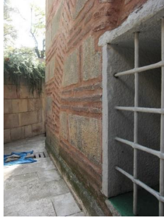
Şekil 5.25. Duvar diplerinde görülen bitki ve yosunlaşmalar.
