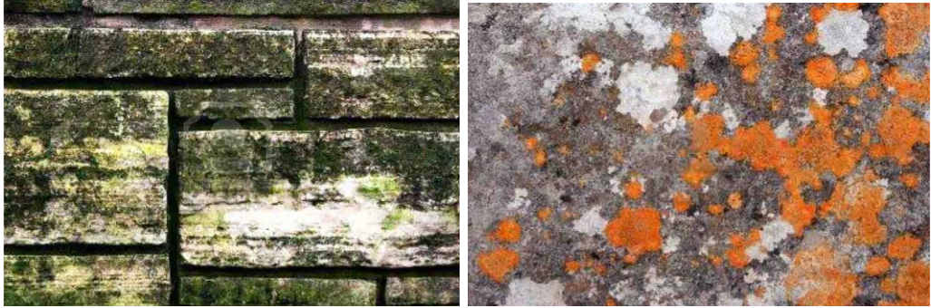
Şekil 2.20. Taş yüzeylerde mantar oluşumu (Dolar vd, 2014).
