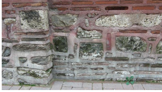
Şekil 5.15. Üftade Camii duvar eteklerinde meydana gelen yosun oluşumları.
