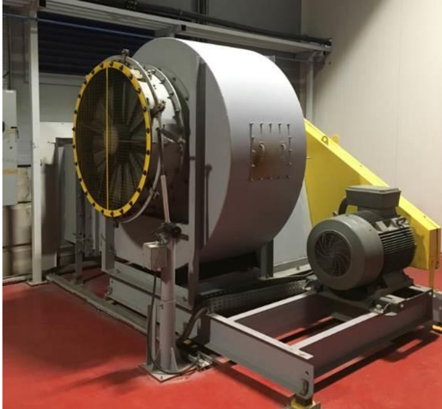
Şekil 7.9. Cooling elektrik motoru.
