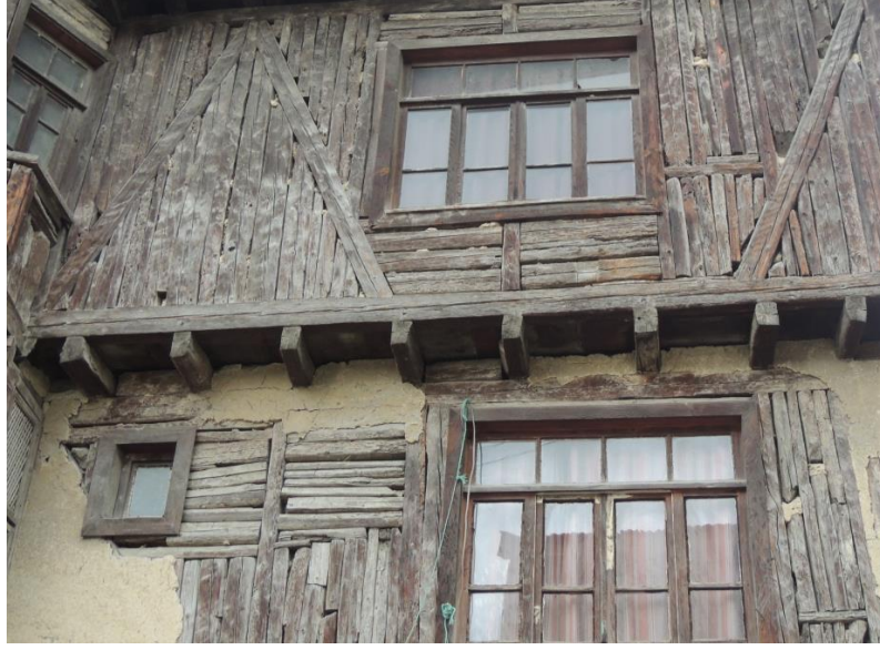
Şekil 3.23. Dizemelerin sıva tutamaması örneği (Güneş, 2014).
