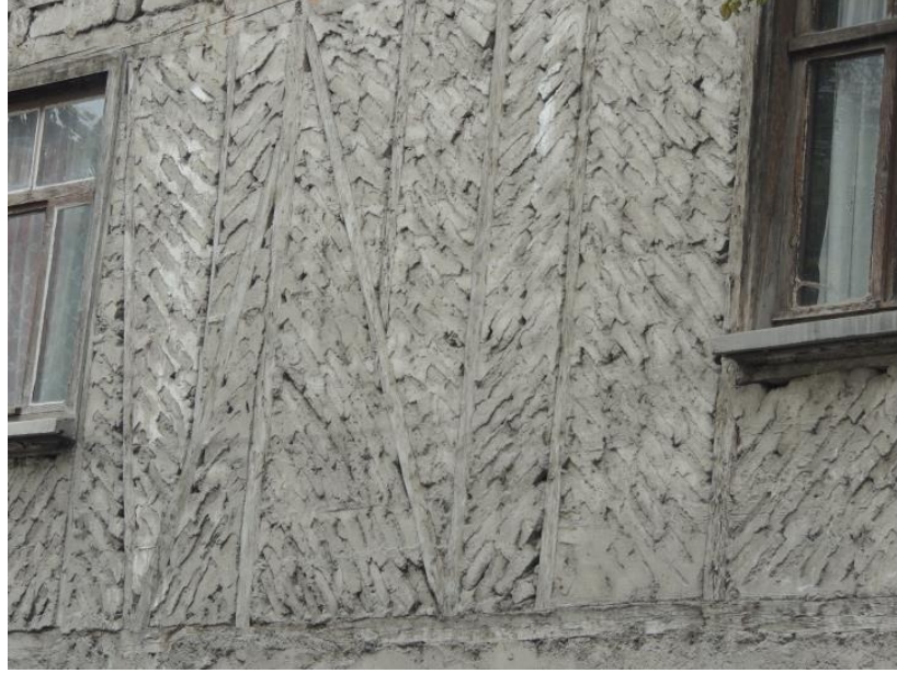
Şekil 3.25. Balıksırtı tuğla dolgulu duvar örneği (Güneş, 2014).
