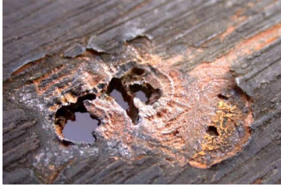
řekil 4.4. Metal malzeme yzeyinde meydana gelen ukurcuk korozyonu.
