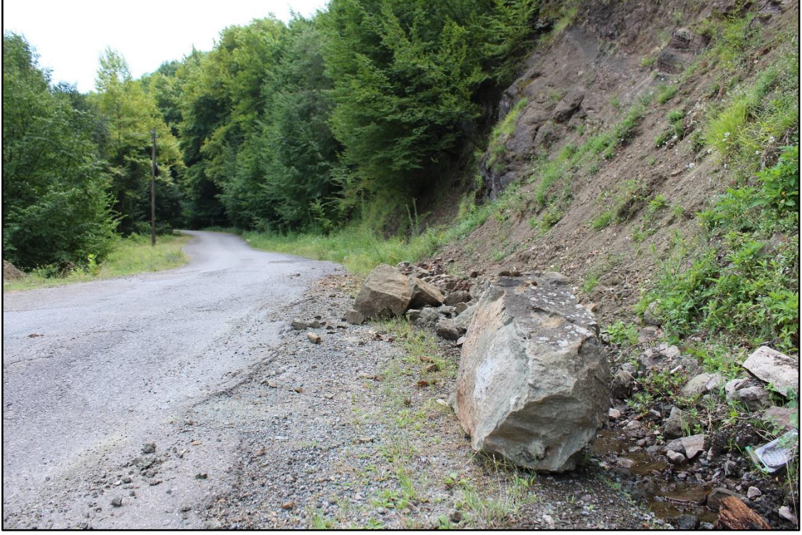
Fotoğraf 6. Yeşilköy karayolu kenarında gerçekleşmiş bir kaya düşmesi.
