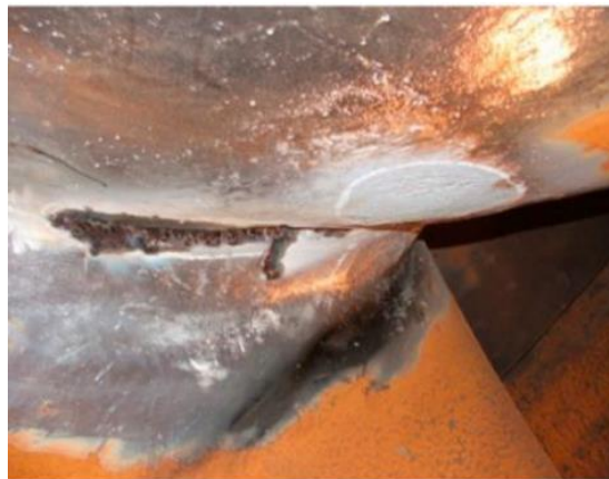
Şekil 4.2. Kılavuz kanadına ait bir erozyon aşınma örneği [58].
